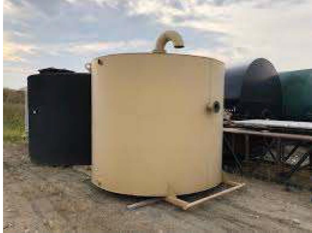
Tanque con venteo abierto (emisiones atmosféricas)
